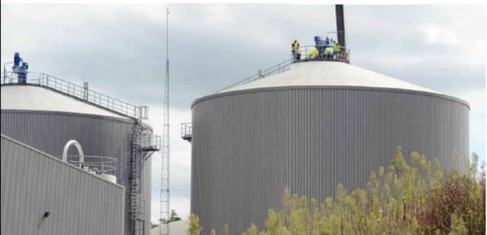
Les silos qui abritent les « digesteurs » des lisiers de canards gras, responsables du mauvais fonctionnement de la « plus importante usine de méthanisation de France », d'après ses constructeurs. PHOTO: B. BOURGEOIS
